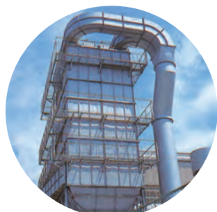
排気浄化プラント
