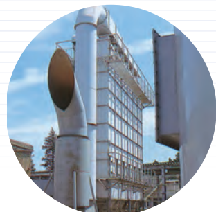
排気浄化プラント
