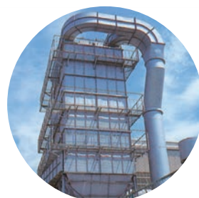
排気浄化プラント
