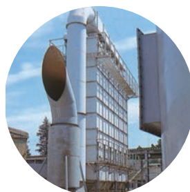
排気浄化プラント
